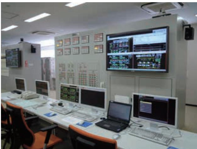
LNG 基地運転訓練シミュレータ
