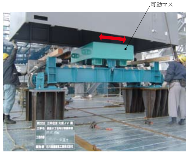
第3図 銀座三井ビルディングと制振装置の外観 Fig. 3 Ginza Mitsui Building and mass damper
