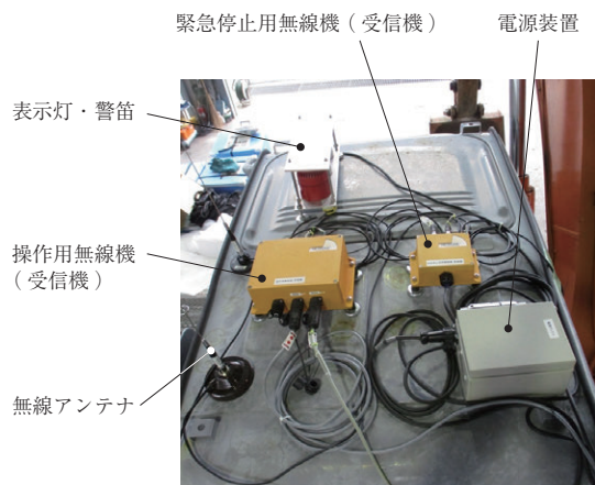
第12図 無線機など設置状況 Fig. 12 Installation status of radio equipment
