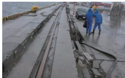
第 7 図 仙台塩釜港高砂コンテナターミナルの岸壁被災状況 Fig. 7 Damage to the quay at the Takasago container terminal in the Sendai-Shiogama Port
