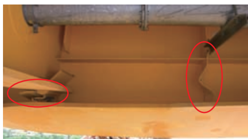
第9図 補剛材の座屈 Fig. 9 Buckling of stiffeners
