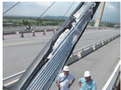
第 7 図 ケーブルの損傷状況 Fig. 7 Stay cable damage
