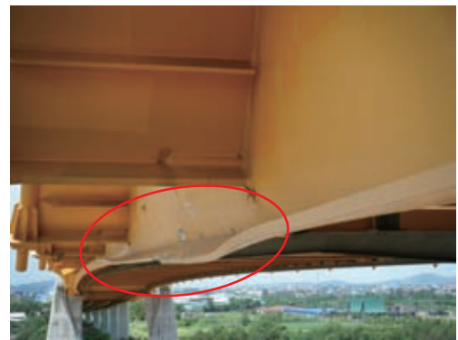
第 5 図 主桁外側の損傷状況 Fig. 5 Steel girder damage ( outer side )
