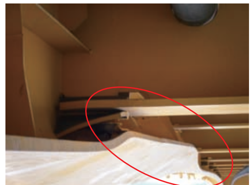
第 6 図 主桁内側の損傷状況 Fig. 6 Steel girder damage ( inner side )
