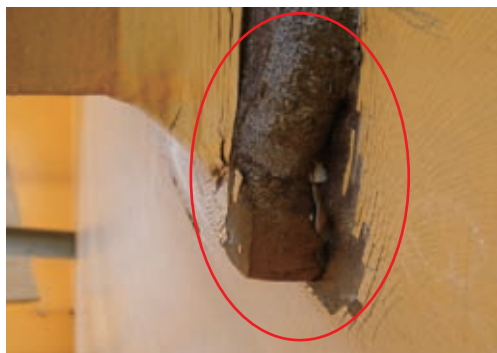
第8図 腹板のき裂 Fig. 8 Crack in web plate
