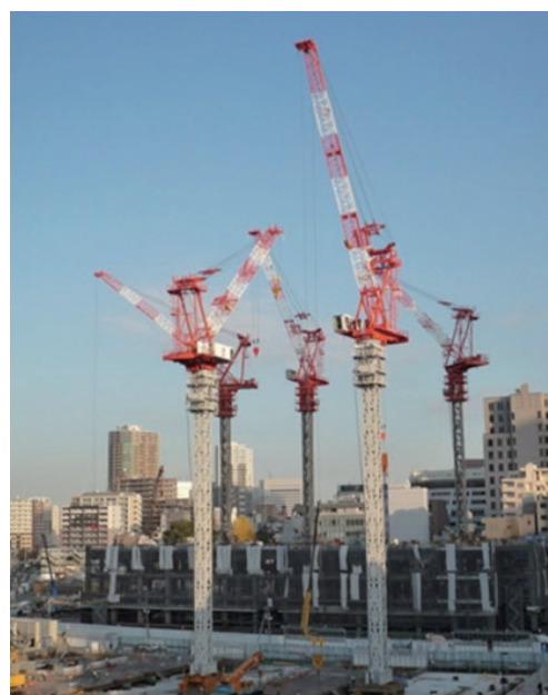
起伏ジブ式クライミングクレーン
