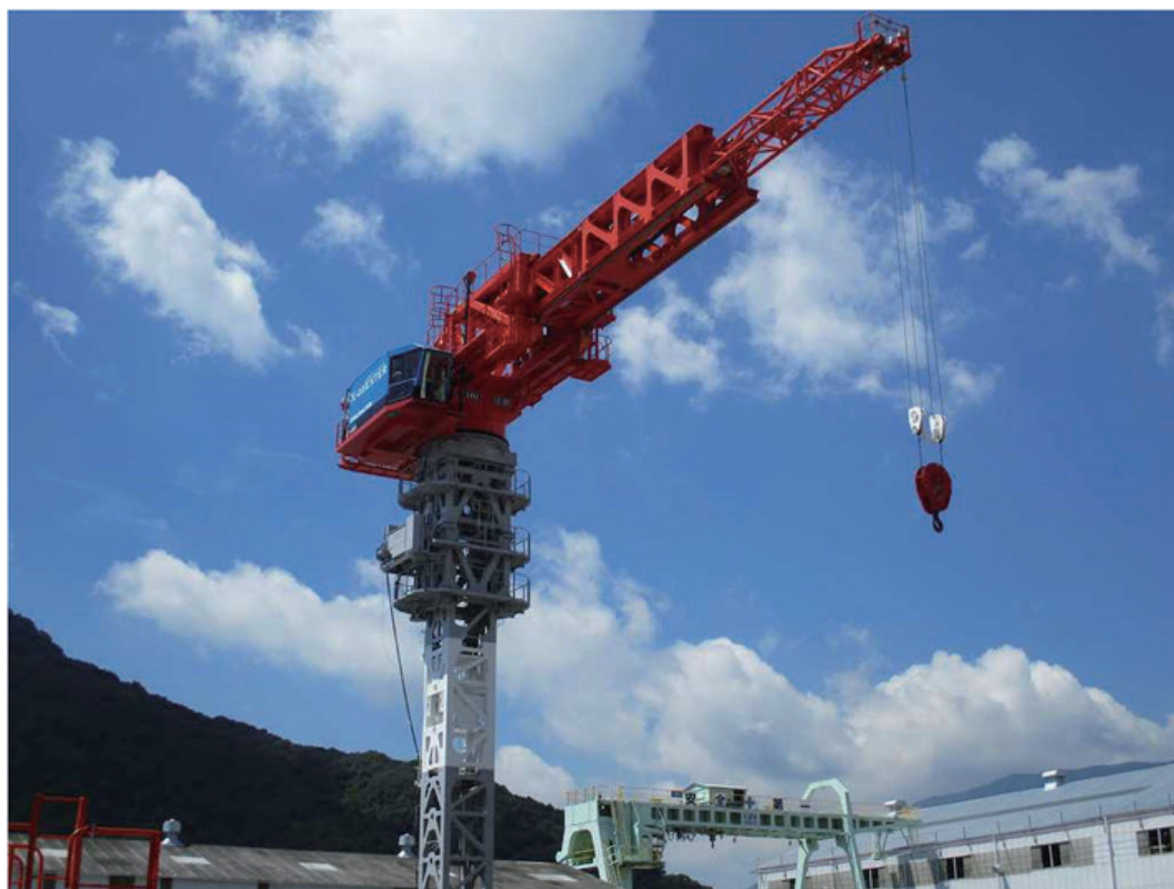
水平スライドクレーン全景
