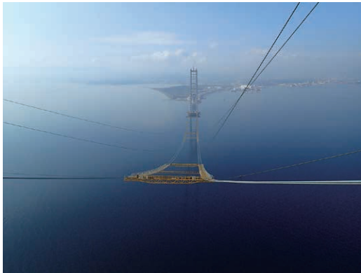
第 27 図 ホーリングシステムおよびキャットウォーク Fig. 27 Hauling rope and catwalk
