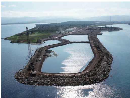
第 15 図 南側アンカレッジエリアの埋め立て Fig. 15 Reclamation of south anchorage area
