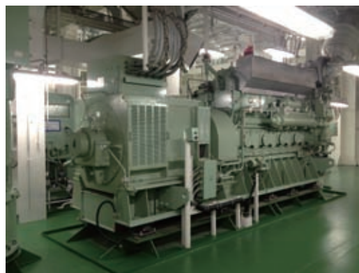
第 8 図 ディーゼル発電機全景 Fig. 8 Diesel generator
