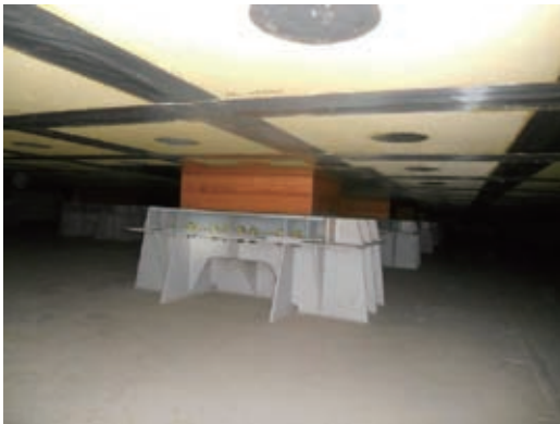
第 5 図 IHI-SPB の支持台構造部 (「Polar Sprit」, 船齢 18 年) Fig. 5 Supporting structure of IHI-SPB (“Polar Sprit” 18 years old)
