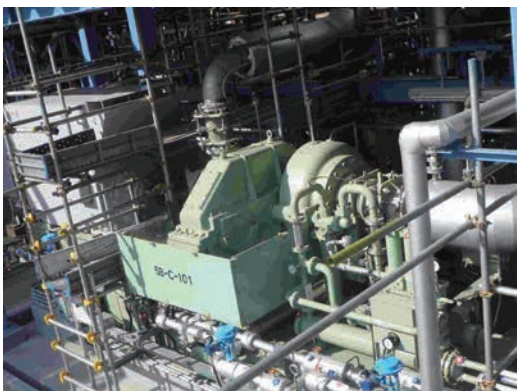
第3図 現地圧縮機据付け状況 Fig. 3 View of compressor on site
