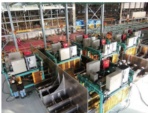
第11図 桁目ロボットの設置状態 Fig. 11 Installation conditions for lattice assembly robot on the block
