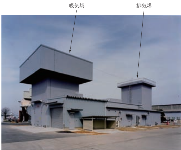
水冷式低バイパス比ファンエンジン試運転用騒音低減施設
