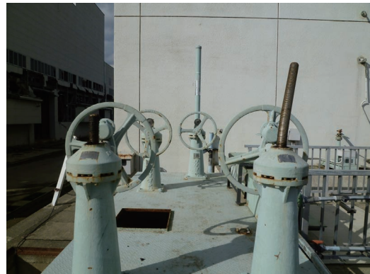
第7図 津波によってゲートのスピンドルが変形（気仙沼終末処理場）
