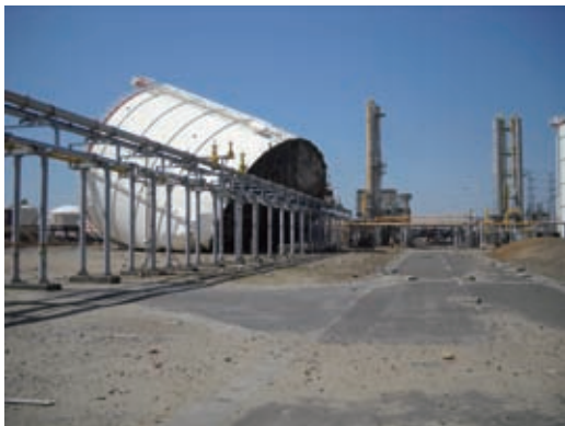
第2図 津波によって流出したガスタンク（仙塩浄化センター） Fig. 2 Gas tank swept away by the tsunami (Senen Waste Water Treatment Plant)
