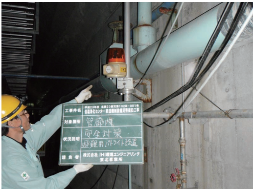
第5図 仙塩浄化センター緊急地震速報装置（パトライト）設置状況
