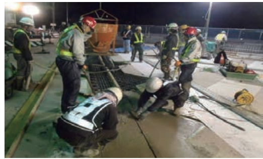
第 17 図 現場打ちコンクリート打設状況 Fig. 17 Pouring of CIP concrete at girder end
