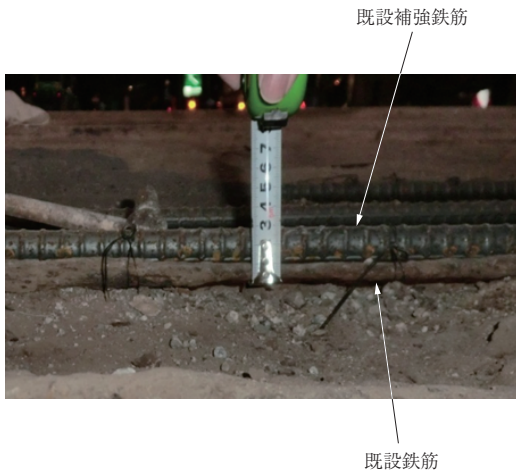
第 3 図 断面欠損した既設鉄筋と既設補強鉄筋
