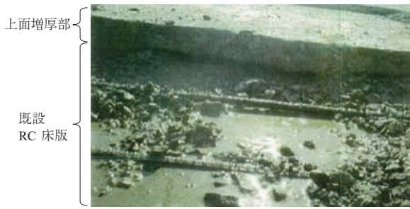
第 2 図 RC 床版コンクリートの砂利化
