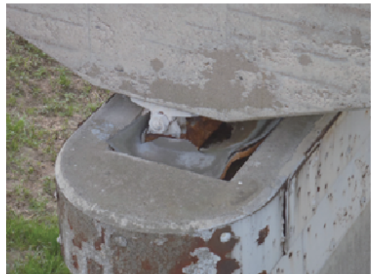
橋脚上の支承損傷状況
