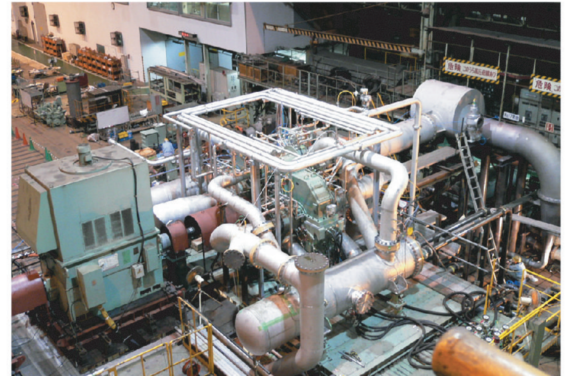
酸素ターボ圧縮機全景
