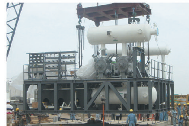
BOG圧縮機（吊上げ中）
