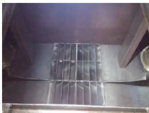
油槽内ダクト
