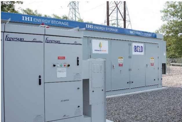
IHI INC. の Energy Storage 部門が納入した大型蓄電システム
