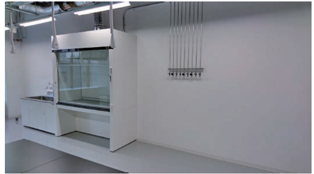
実験室へのガス配管
