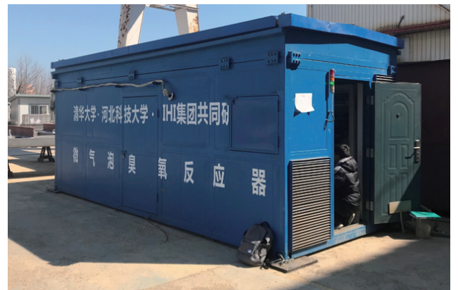
オゾン微細気泡水処理デモプラント
