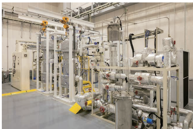
No.1 セルに設置されたメタン合成試験設備
