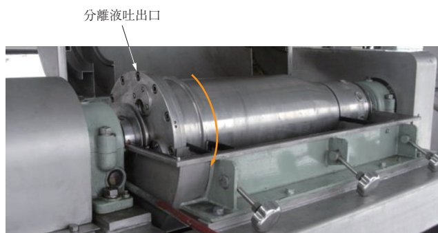
省エネ機テスト状況
