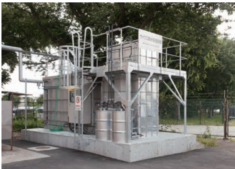
INC の排水処理システム
