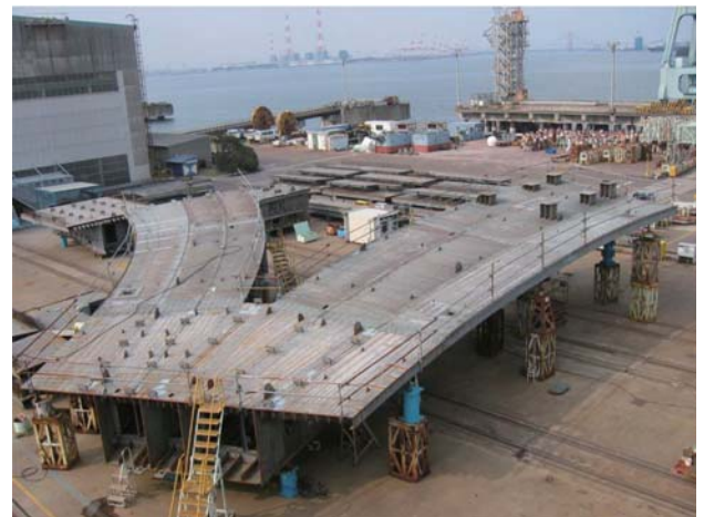
第 8 図 主桁分岐部仮組立状況 Fig. 8 Temporary assembly of the main span junction
