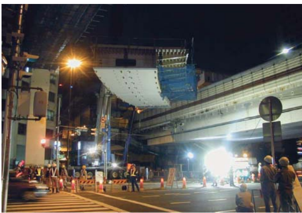
第 20 図 曲線部上部工一括架設 Fig. 20 Erection of upper structure of curved section
