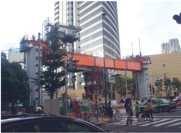
第 19 図 山手通りを横断する門型ベント Fig. 19 Gate type vent crossing the Yamate-Dori Street
