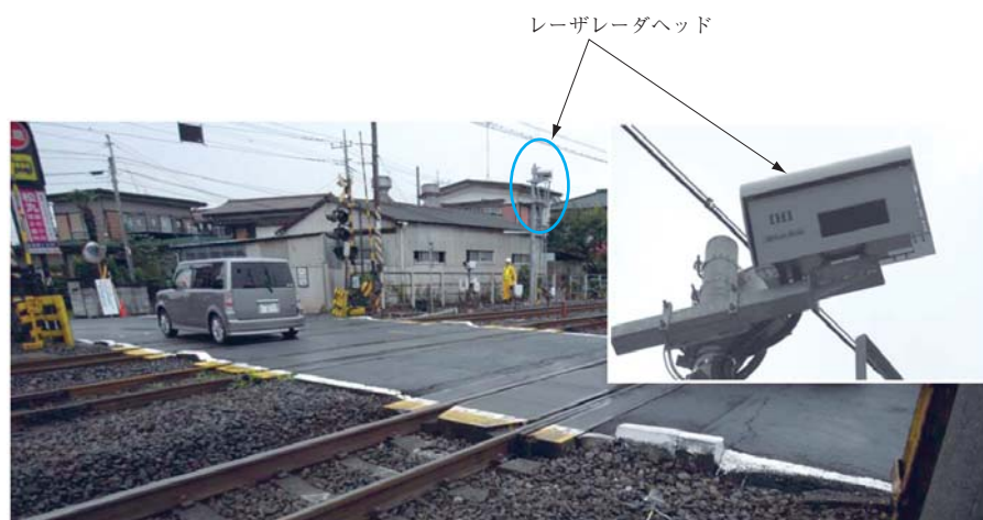
第6図 踏切障害物検知装置の設置状況
