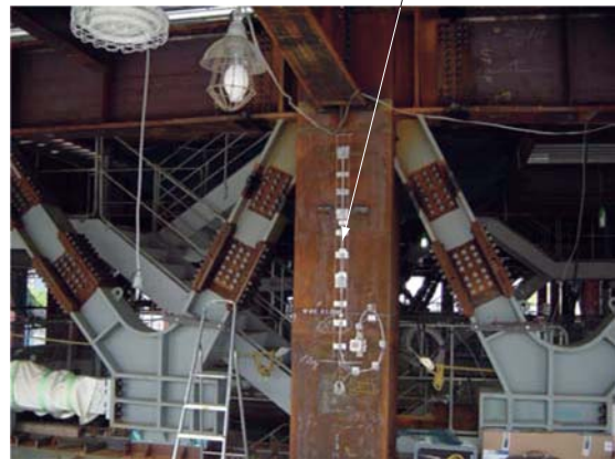
第 17 図 SOFO センサ（柱：X7Y9） Fig. 17 SOFO sensor ( column : X7Y9 )
