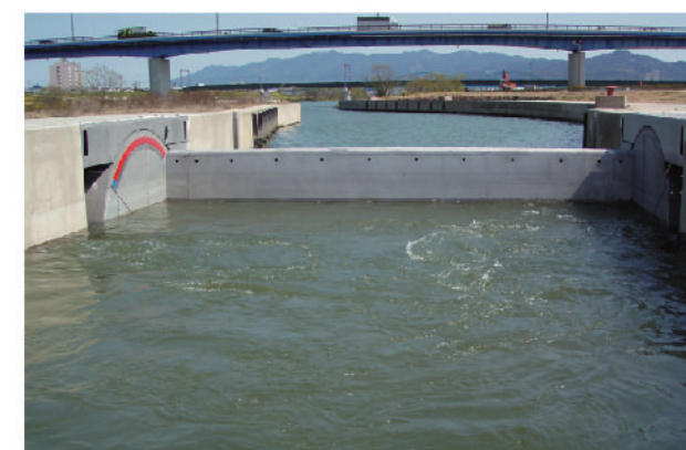
閘門設備採用例
