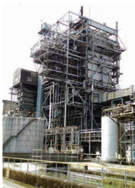
株式会社シグマパワー有明 三川発電所で稼働している 700°C級実証試験用設備
