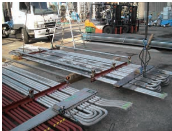
IHI 相生工場で溶接した 700°C級実証試験ループ
