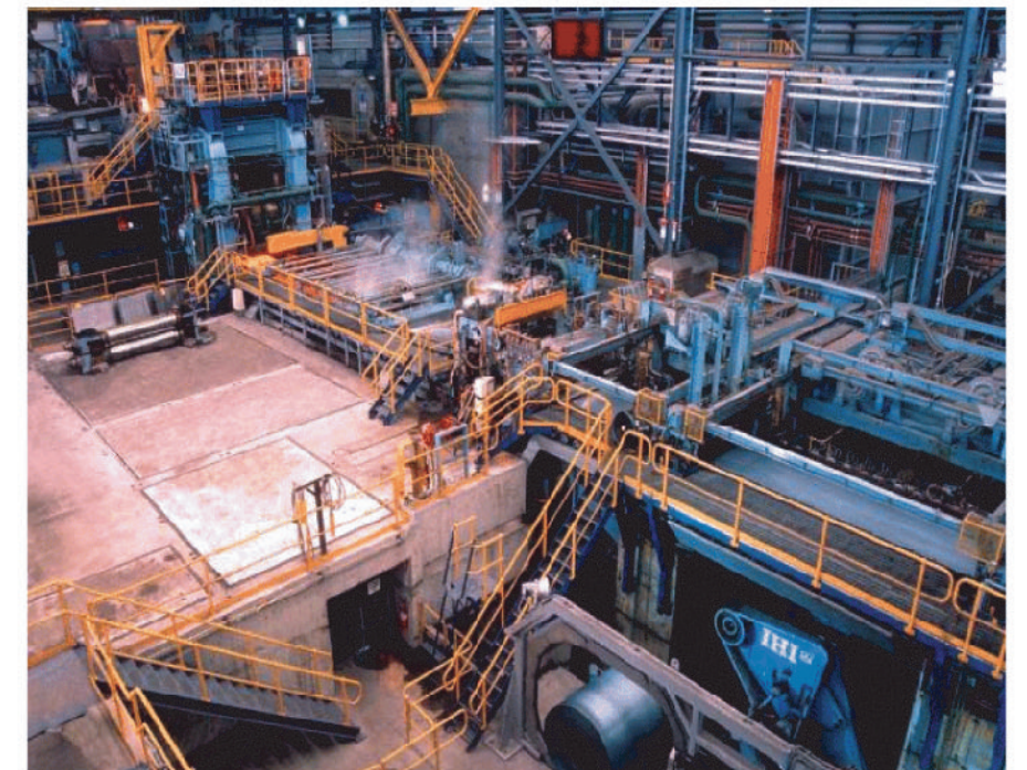
BHP社に建設された60トン規模商用化実証プラント
