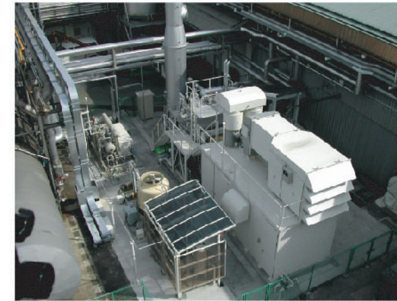
IM270コージェネレーション設備
