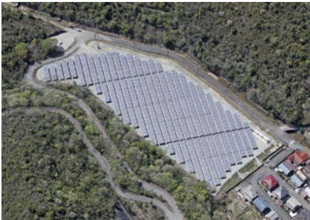
相生佐方太陽光発電所全景
