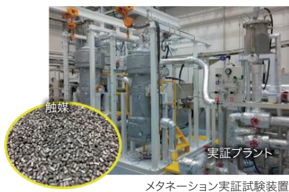
メタネーション実証試験装置
