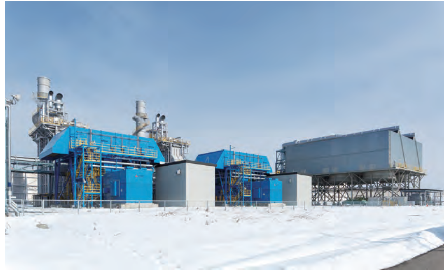
LM6000ガスタービン複合発電設備
