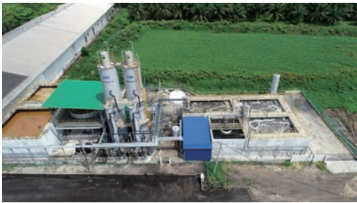
第 13 図 POME 処理実証試験設備の外観 Fig. 13 POME treatment plant overview
